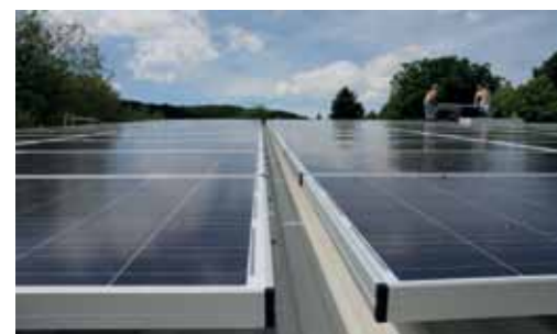
Die Photovoltaikanlage auf dem Pultdach des neuen Laborgebäudes PlanCoTec
